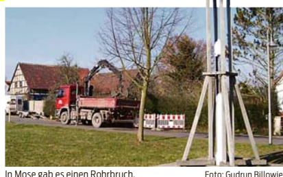
In Mose gab es einen Rohrbruch.
